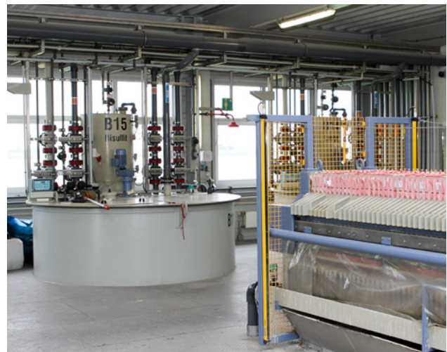
Zentrale Abwasserbehandlungsanlage Nordenham
