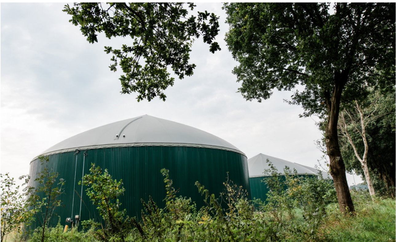
Externer Biogasreaktor – aus dem Blockheizkraftwerk zur Verstromung des Gases geht der Wärmeanteil in den Standort Varel.
